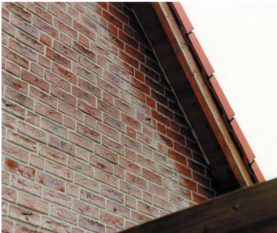
Vergrauwung: kenmerkend is de scherpe begrenzing tussen het beregende en droge deel van de gevel.
