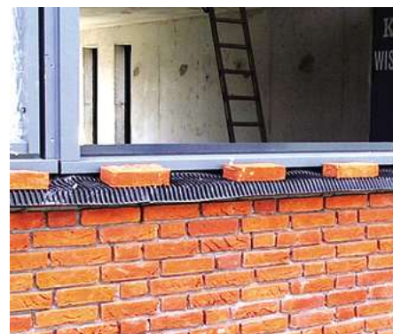
Tijdelijke waterslag tegen invregenen in het metselwerk.
